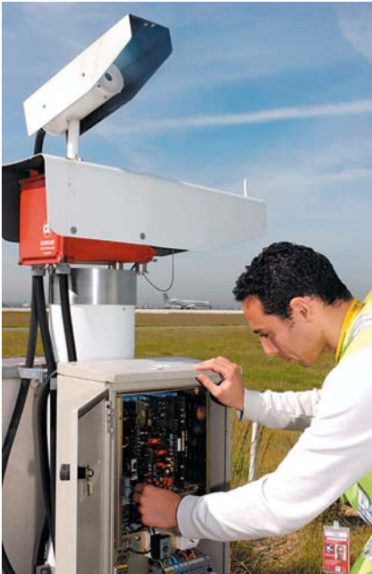
Maintenance d'un transmissomètre à Roissy. (Photo Météo-France, P. Taburet)
